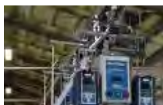
搾乳ユニット搬送レール
