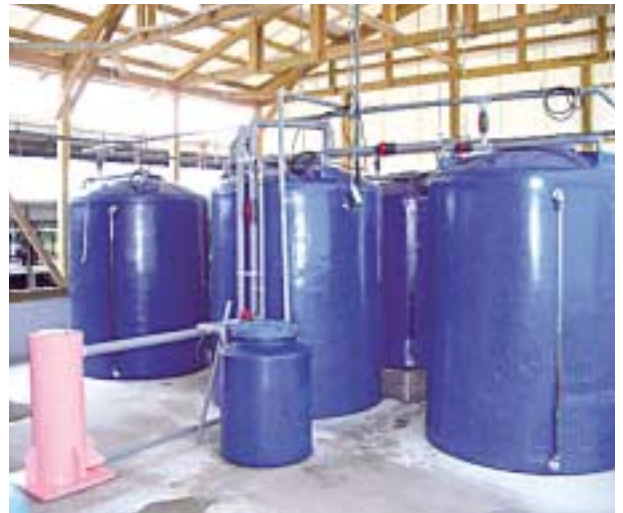
グリーンバシシステムの設備
