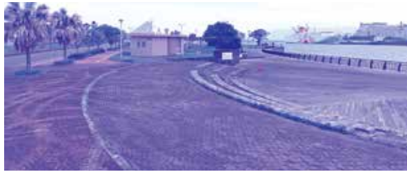
老朽化が進む観光船バース
