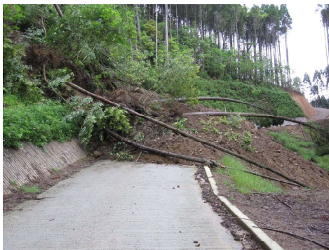
林道災害 被災直後
