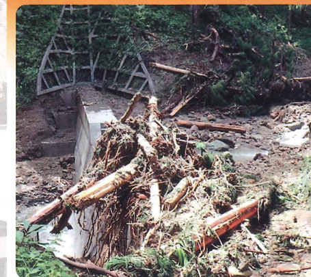
治山ダムが土砂や流木の流出を防止
