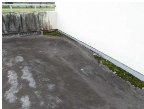
屋根防水の劣化（3号棟）
