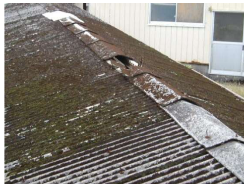
外部通路屋根の破損
