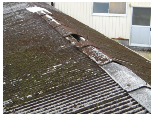
外部通路屋根の破損
