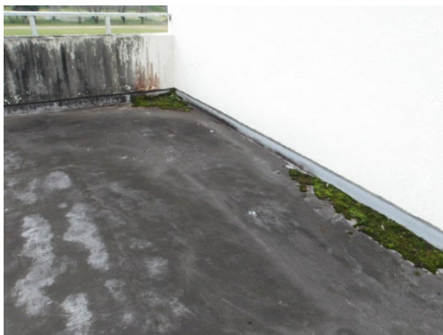
屋根防水の劣化（3号棟）
