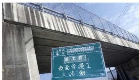
稚子松跨道橋 補修前
