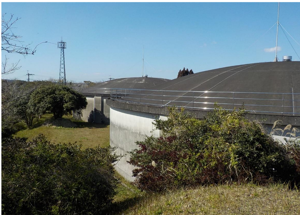
中央地域 大迫配水池
