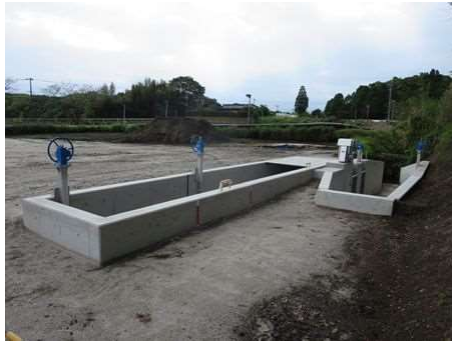
ほ場整備事業で整備した転倒ゲート
