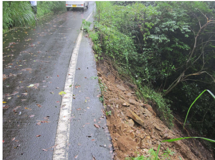
林道災害 被災直後
