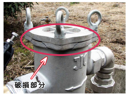
凍結により破損した給水装置
