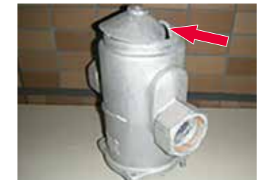
凍結により破損したストレーナー（矢印部分）
