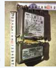
発火した充電式バッテリー
