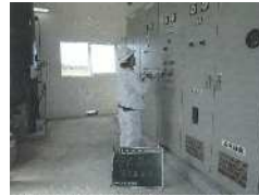
施設の保守点検
